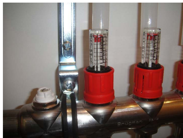
Afbeelding 2 – Debietmeters op een collector
