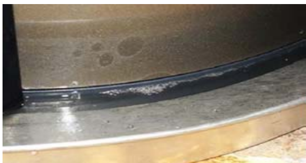
Figuur 14: Schade door slechte condensaatafvoer
